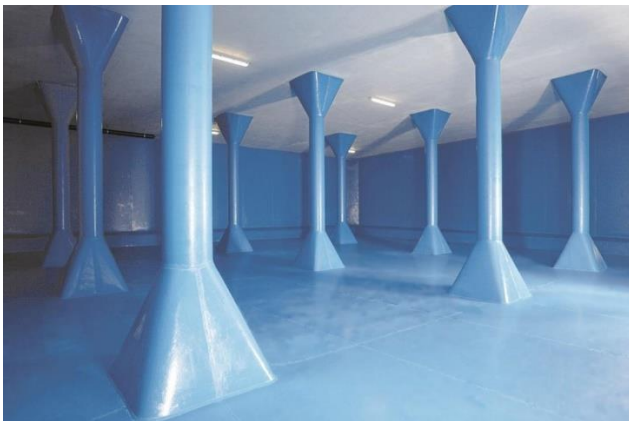
Hydroclick bekleding drinkwaterkelder
