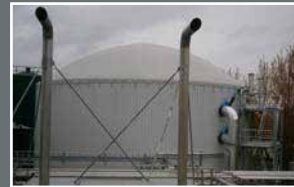
Solid Waste Digestion Enprotech BioGestor
